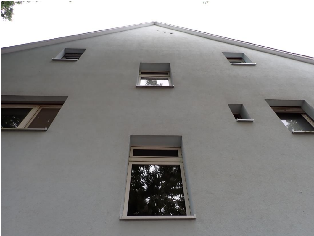
Abb. 4: Fassade ohne Spaltenpotenzial für Fledermäuse oder Nischen für Vögel.
