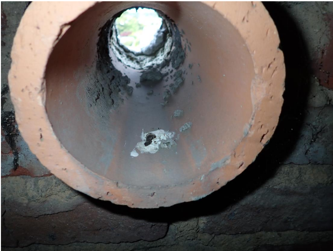
Abb. 9: Lüftungsrohre mit Kot vom Haussperling.
