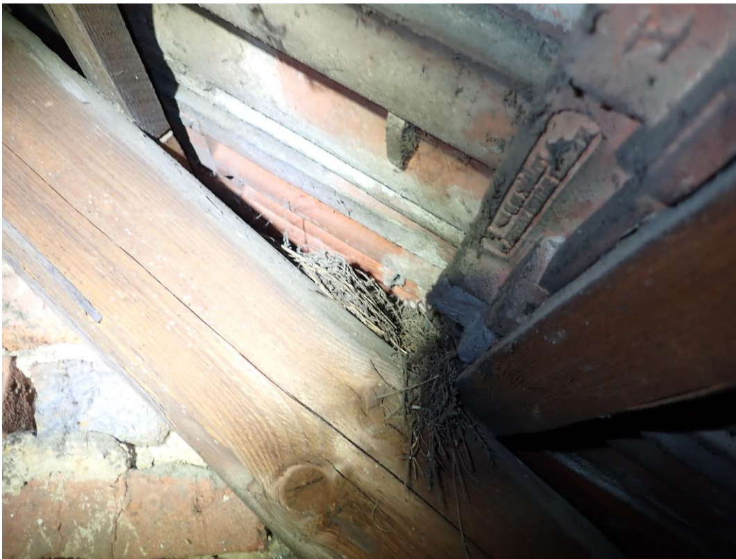
Abb. 7: Mauerkrone im Bereich der Geibel mit Nistmaterial vom Hausperling.
